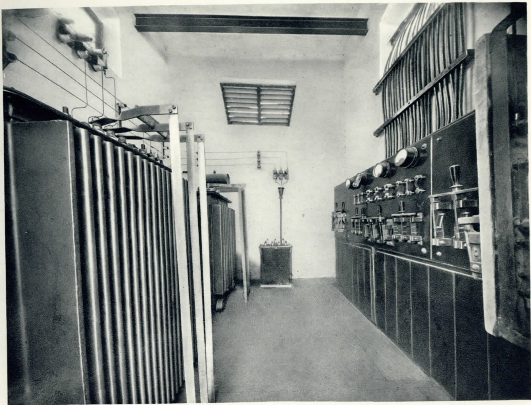
Caseta de transformadores; de 5.000 a 220 voltios.
